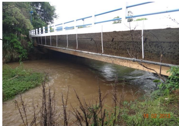
Foto 4.23 - Travessia na rua São Paulo que possui problemas de inundação e assoreamento.
