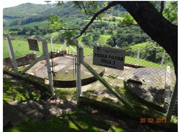
Foto 4.19 - Fossa Filtro VNSA 2
