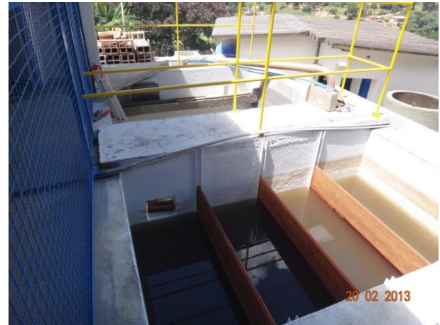
Foto 4.13 – Detalhe dos filtros da ETA SRF
