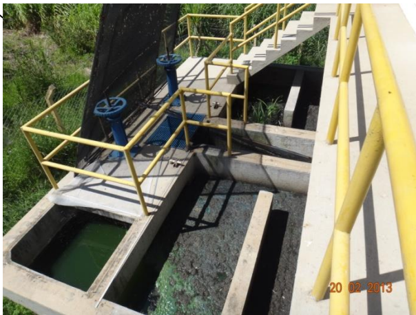
Foto 4.16 - Chegada Esgoto Bruto
