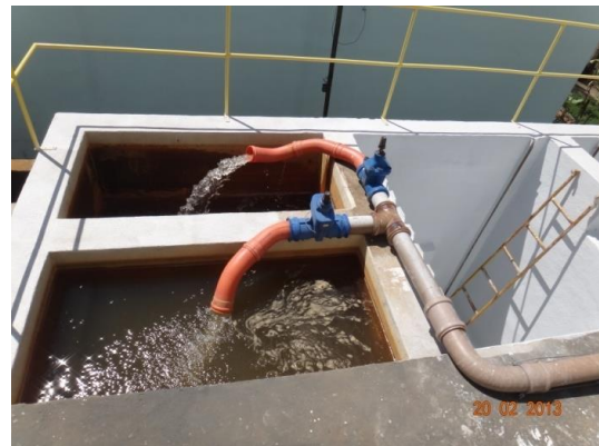
Foto 4.8 – ETA em detalhe
