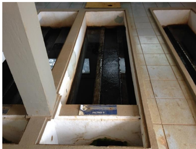
Figura 72 - Filtro 3 da ETA, nota-se a clarificação da água após a passagem pelos filtros.
