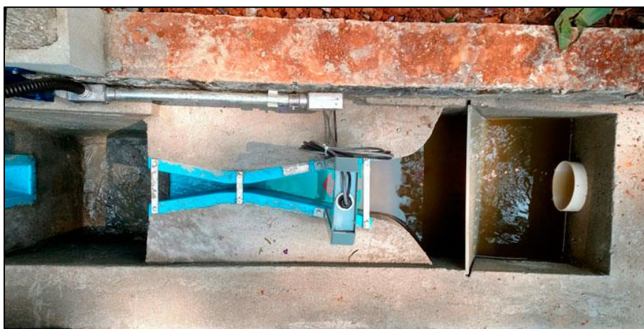
Figura 78 - Calha Parshall para medição de vazão.
